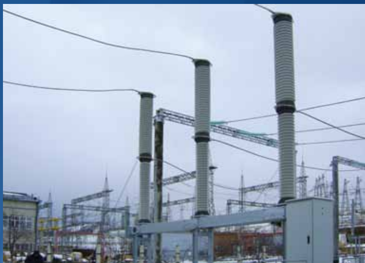
ВГТ-УЭТМ®-1А1-220 на подстанции "Большая Еловая", ЯНАО
