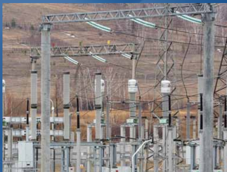
ВГТ-УЭТМ®-1А1-220 на подстанции "Алюминиевая", г. Саяногорск
