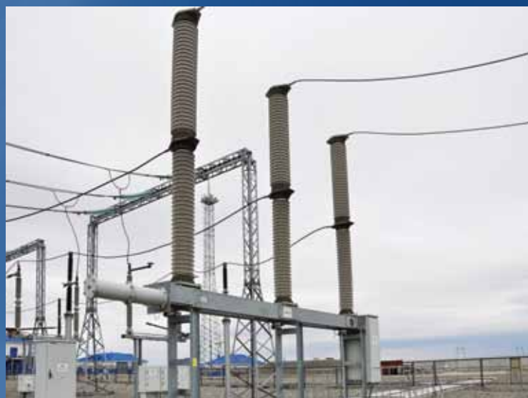
ВГТ-УЭТМ®-1А1-220 на подстанции "Танеко", Республика
