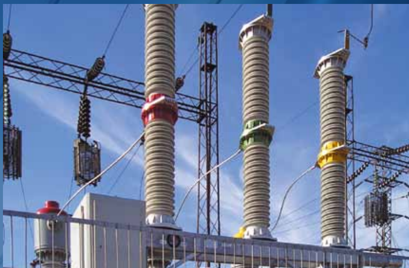
Подстанция г. Обнинск, Калужская область
