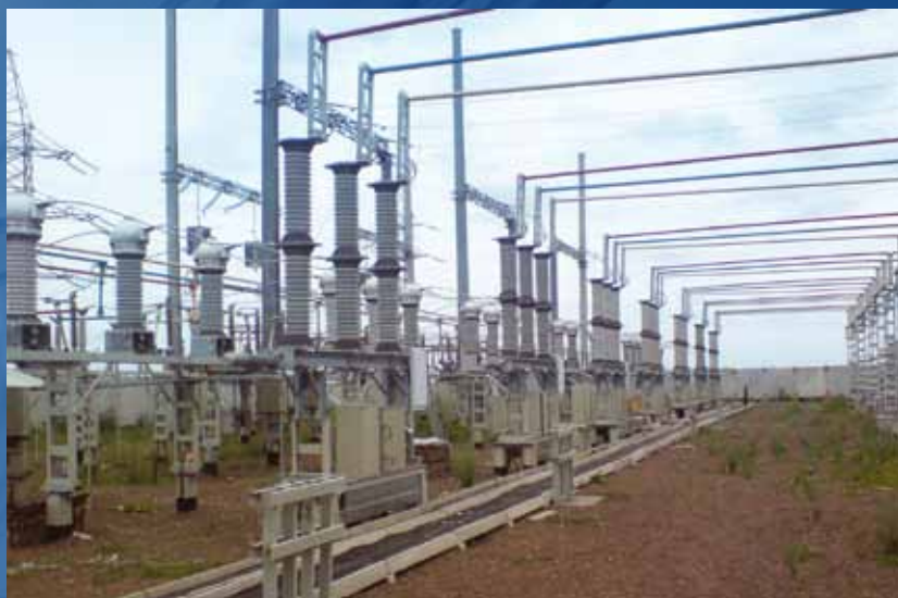
Подстанция "Ростоши", г. Оренбург
